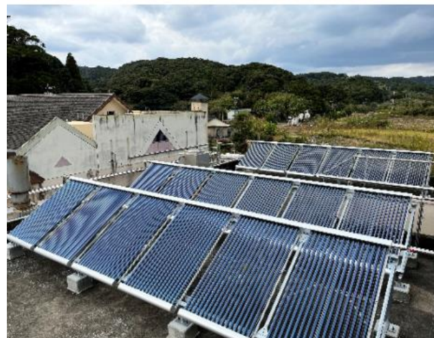
温泉センター屋根に設置された太陽集熱機器
