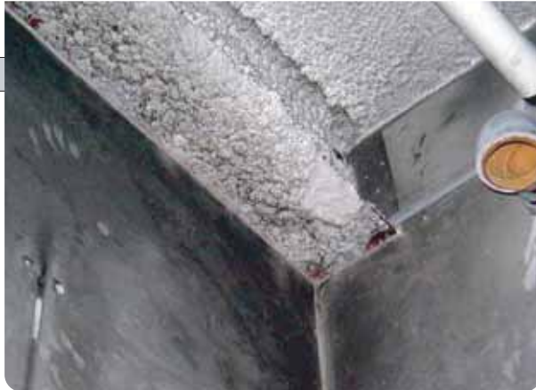
アスベストが使用されている町民センターボイラー室
