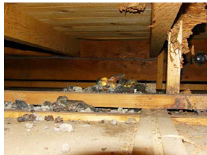
▲天井裏のフン被害
