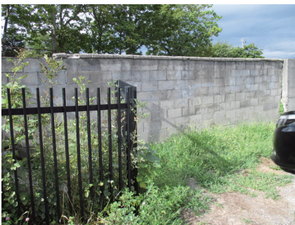
町内ブロック塀の例 幅9m近い間に控壁がない
