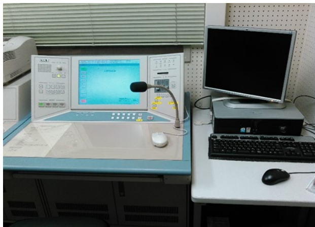
平成29年度SDカード化改修した 同報無線放送装置
