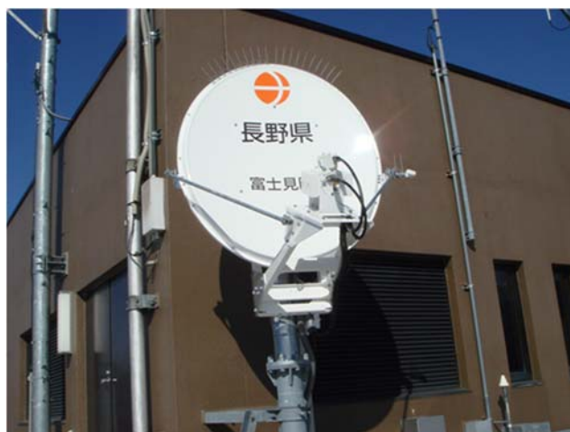
平成28年度更新した長野県衛星系 防災行政無線アンテナ
