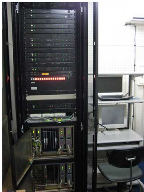
放送システム（センター装置）
