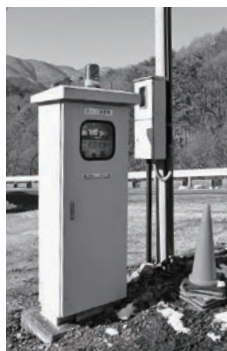
約200軒の汚水をポン プアップし、自然流下方 式が検討されている第3 マンホールポンプ場
