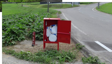
設置した消火栓・消火栓ボックス
