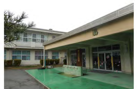
築 47 年を迎え老朽化が進む富士見小学校
