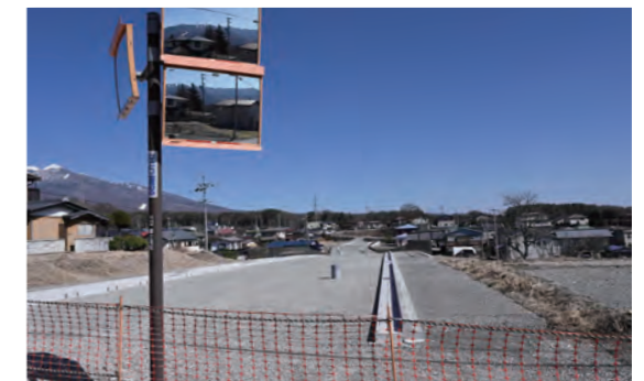
舗装工事が今年度も行われない都市計画道路「富士見駅北通り線」
