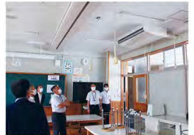
快適な教室環境を醸し出す中学校のエアコン
