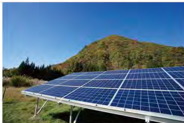
太陽光発電施設
