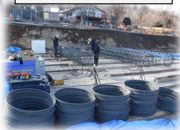
膜ろ過方式浄水場整備
