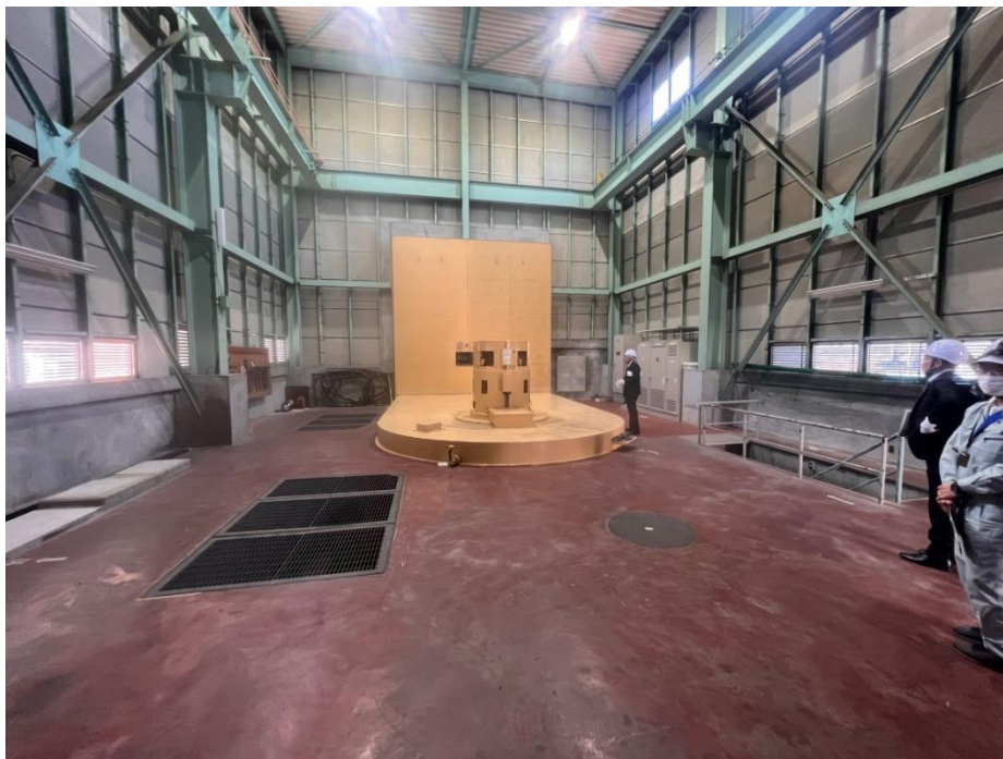
柚ノ木発電所
