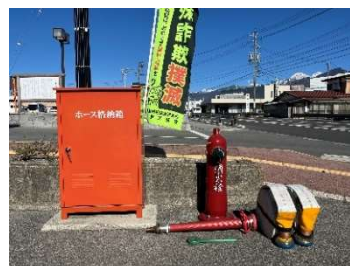
消火栓器具の購入
