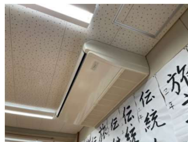
エアコンが設置された教室(イメージ)
