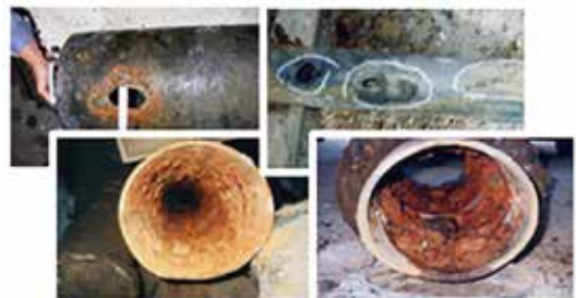
【老朽化した水道管の状況】
