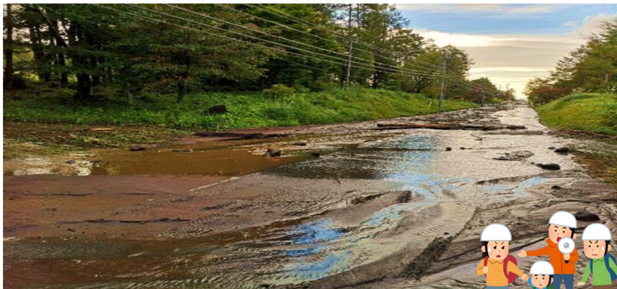
*平成30年 台風24号に伴う災害時において、鉢巻道路に土砂が流入した様子
