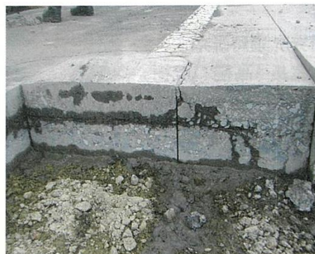
写真-3 基層とアスベースの層間切れ
