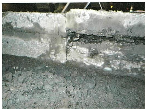
写真-1 表層と基層の層間はく離の例 5) (層間に滞水が見られる)
