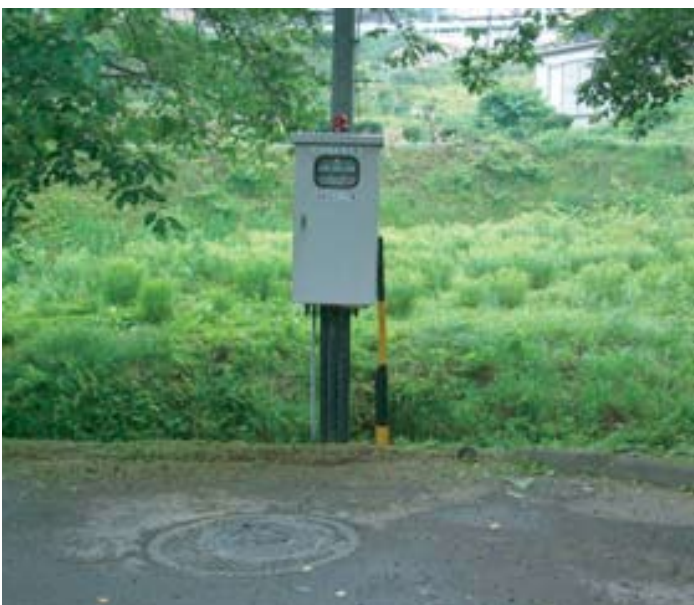
町内55箇所に設置されている下水道圧送ポンプ
