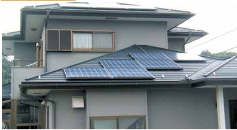
設置された太陽光発電システム
